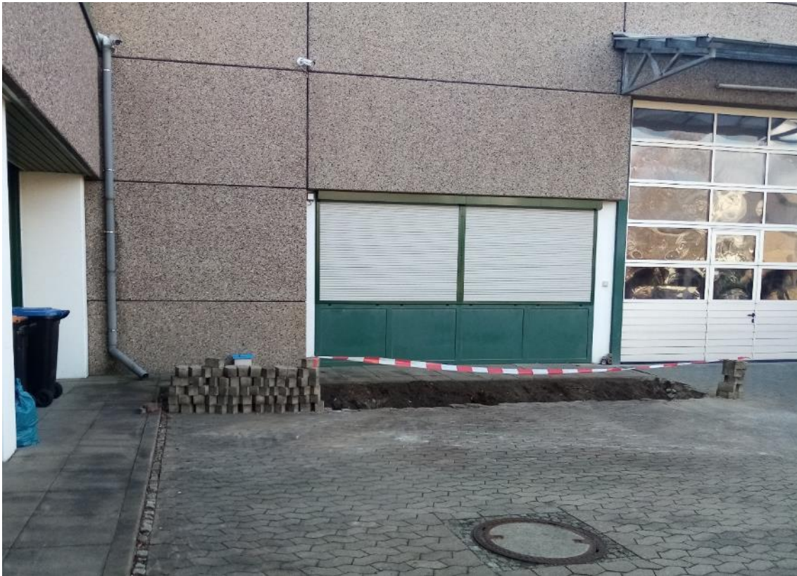
Die Fläche vor der Fassade der Lagerhalle bot einen trostlosen Anblick (29.3.2021)
